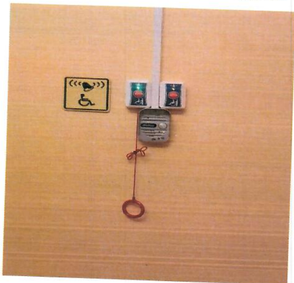
Фото 23 Лифтовое помещение (кнопка вызова сотрудников)
